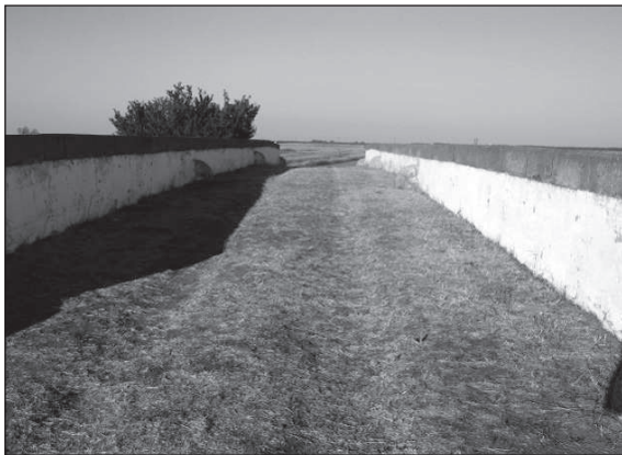
A hídon átvezető út esős időben járhatatlan, sáros-poros földút
